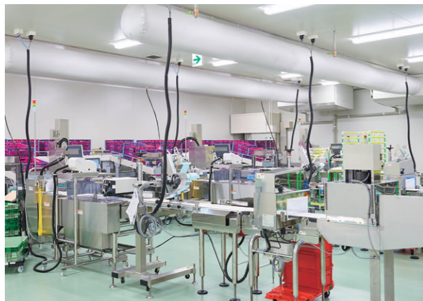
作業者の快適性確保、落下菌抑制のためにソックダクトを採用
